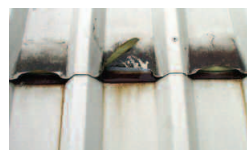
Powłoka z fakturą typu "skórka" na blaszce ocynkowanej ogniowo zastosowana jako pokrycie dachowe po 7 latach eksploatacji.
