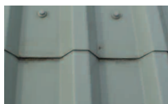
Dach pokryty Colorcoat HPS200 Ultra® z powłoką Galvalloy™ po 7 latach.
