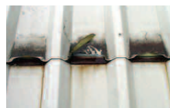
Alternativa all'aspetto "effetto cuoio" su un tetto con substrato di acciaio con zincatura a caldo, dopo 7 anni.
